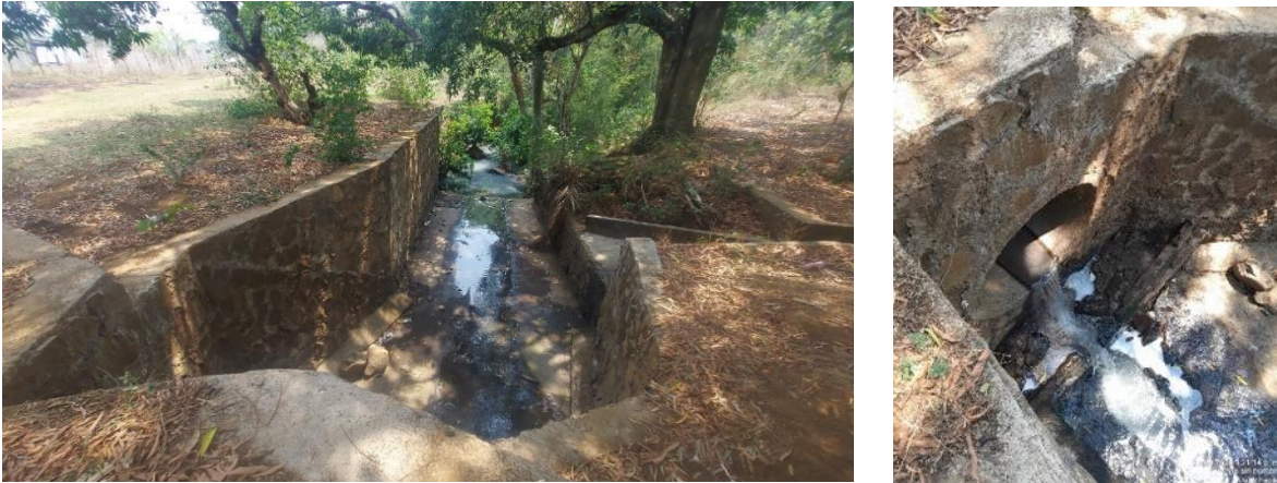
Ilustración 4 Descarga de colector principal de aguas pluviales
