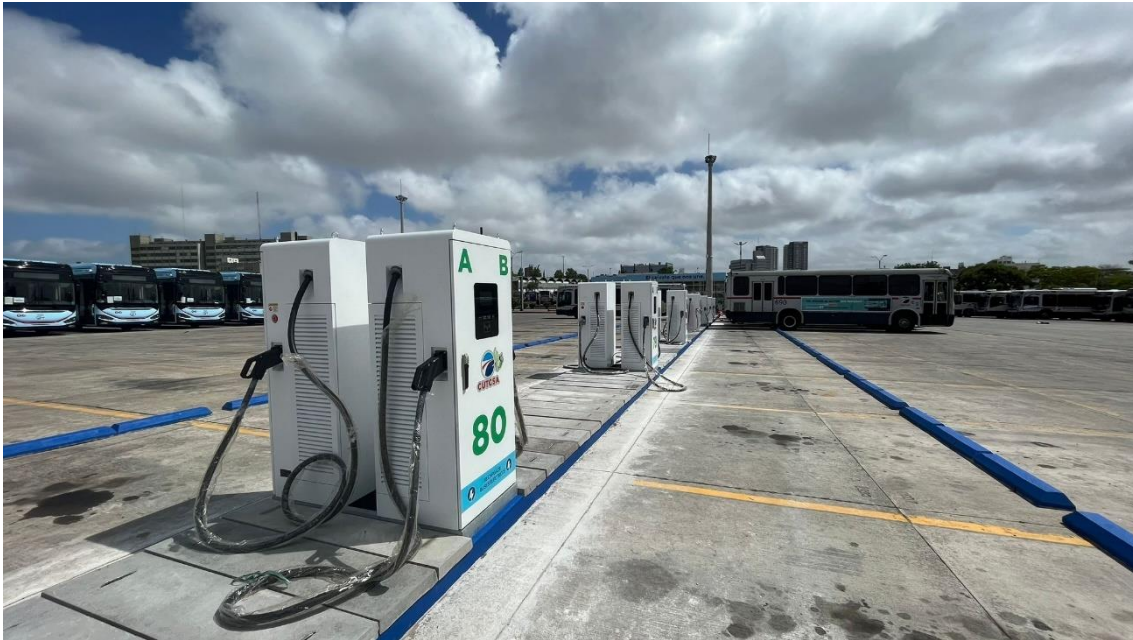
Planta Añón – zona de cargadores ya reformada
